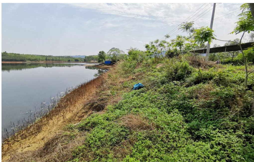
上游坝坡未进行护砌,局部存在凹坑
