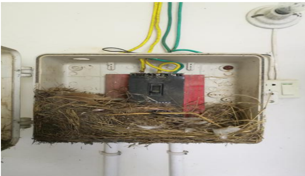
控制室电气开关箱内有鸟窝
