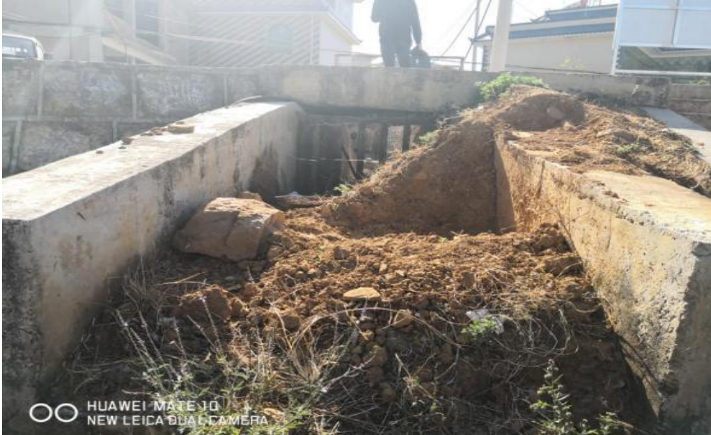
溢洪道进口被沙土堵塞
