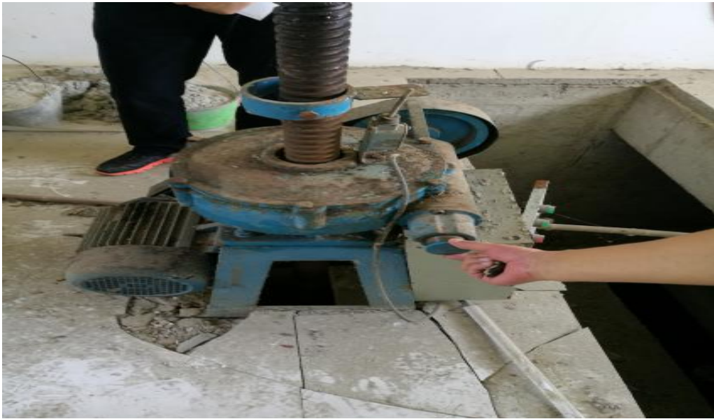
螺杆启闭机限位器及行程开关损坏,电动启闭系统无法使用
