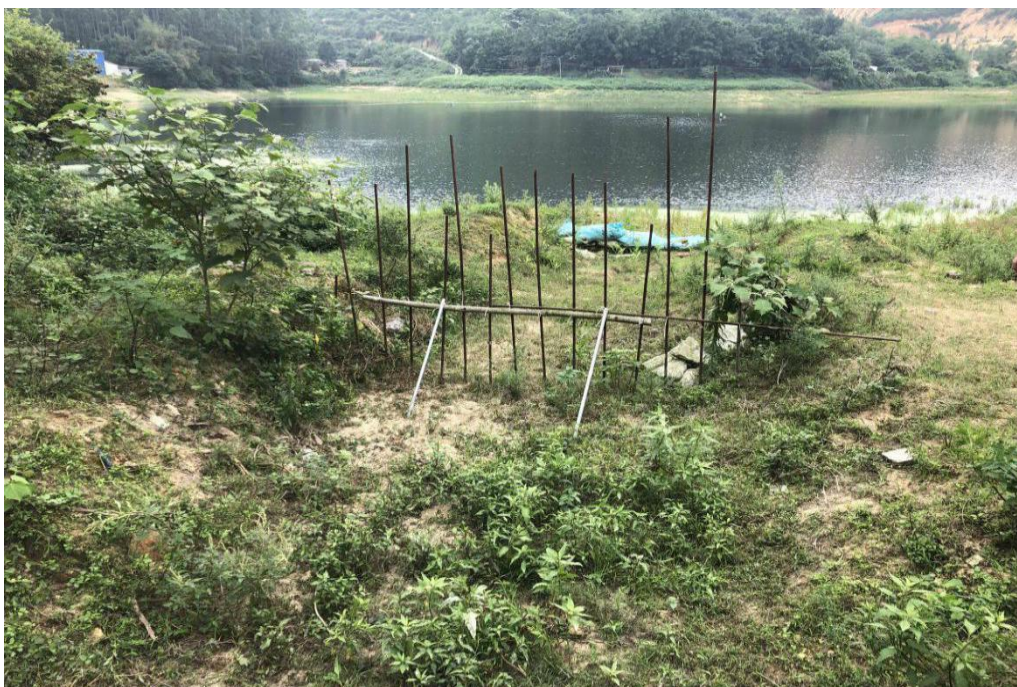
溢洪道入口被铁栅栏封闭
