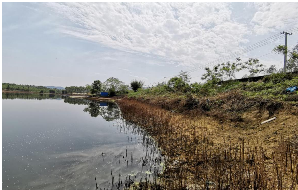
水库年久失修,面貌较差,未设置水尺及雨量设施
