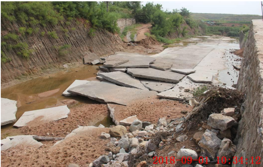
溢洪道底部混凝土面板被冲毁
