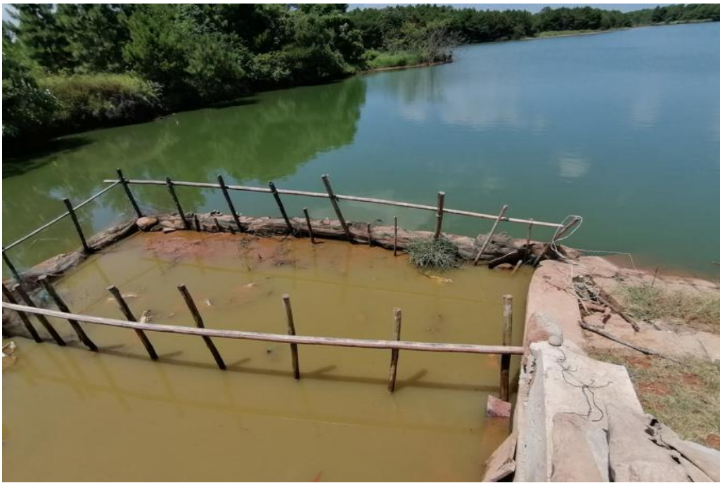
溢洪道进口被人为封堵，雍高水位
