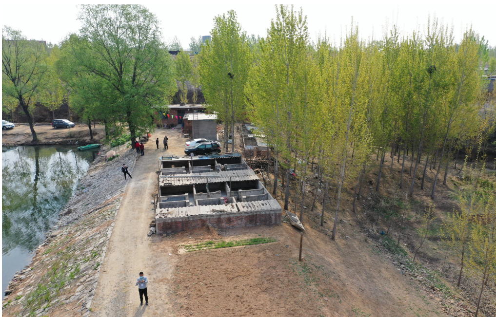
坝顶存在多处违规建设的房屋及养殖场
