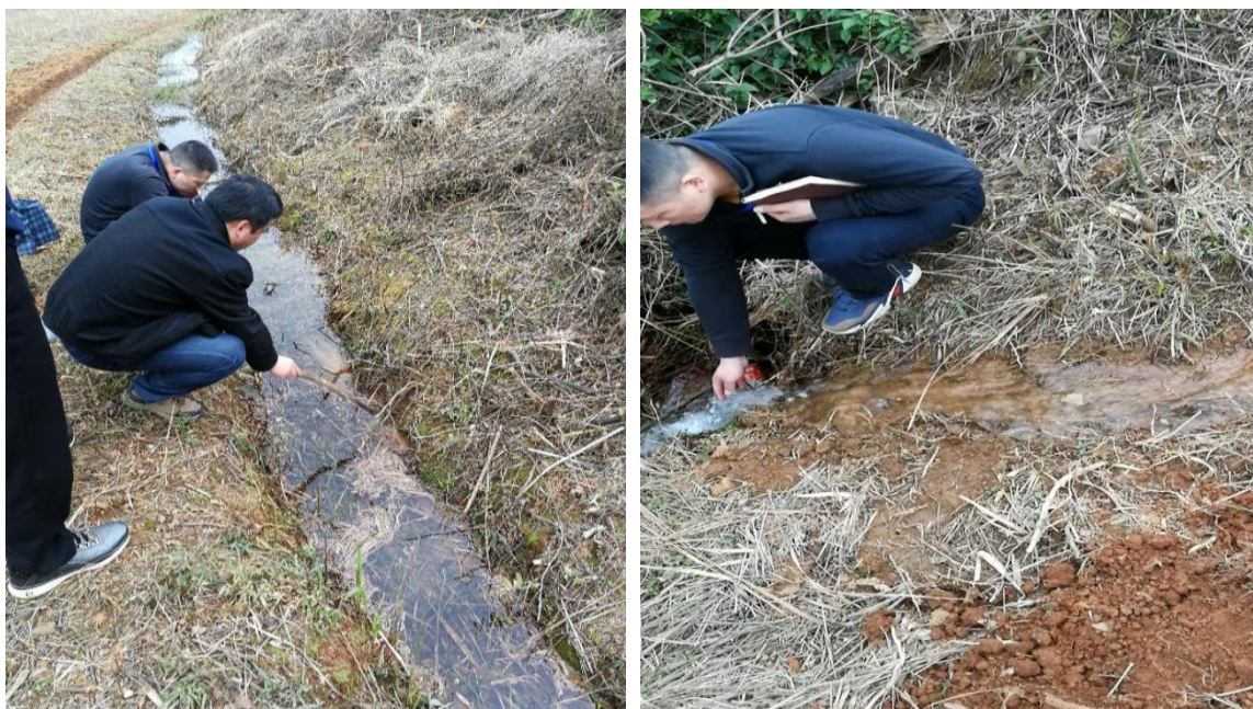
坝左段坝脚渗流异常
